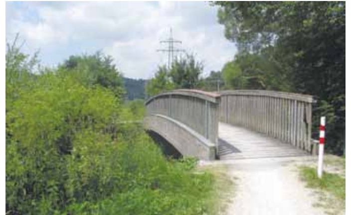
Die Holzbrücke über die Anlauter zwischen Enkering und Kinding ist schadhaft und soll ersetzt werden.
