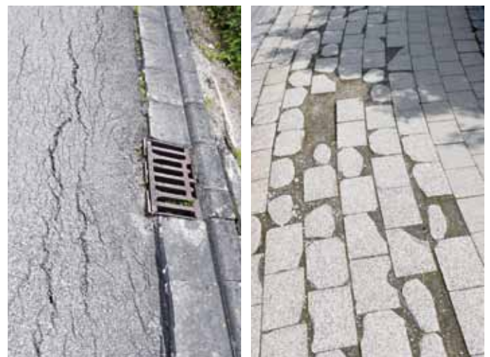
Schäden an der Zufahrt zu Hauptstraße 13 in Enkering und am Gehweg Haunstetten.
