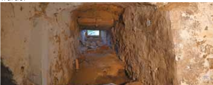
Die rund drei Meter dicken Mauern stammen aus dem 13. Jahrhundert und gehörten vermutlich zu einem bislang unbekanntem Wehrbau des Herrschaftsgeschlechts der Absberger.
