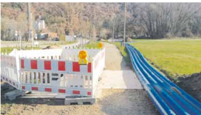
Zwischen den Kindinger Ortsteilen Pfraundorf und Kratzmühle wurde mit einer Spülbohrung eine neue Wasserleitung verlegt, die die Altmühl und die Staatsstraße unterquert. Die im Jahr 2021 begonnenen Arbeiten wurden im Frühjahr 2022 abgeschlossen. (Quelle: WZV Kindinger Gruppe)
